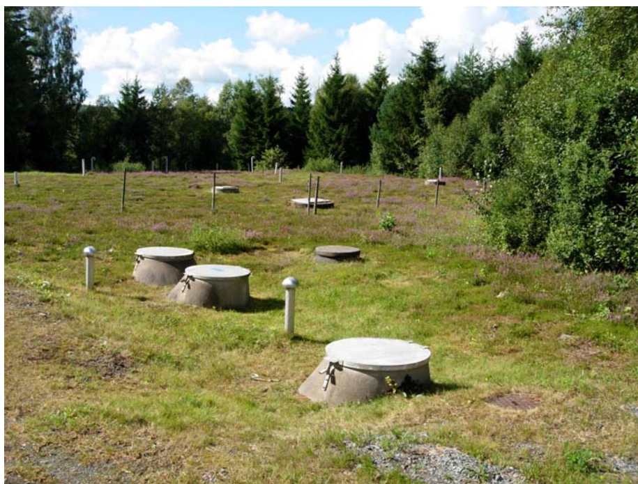
Avloppsreningsanläggning i Ubbhult
